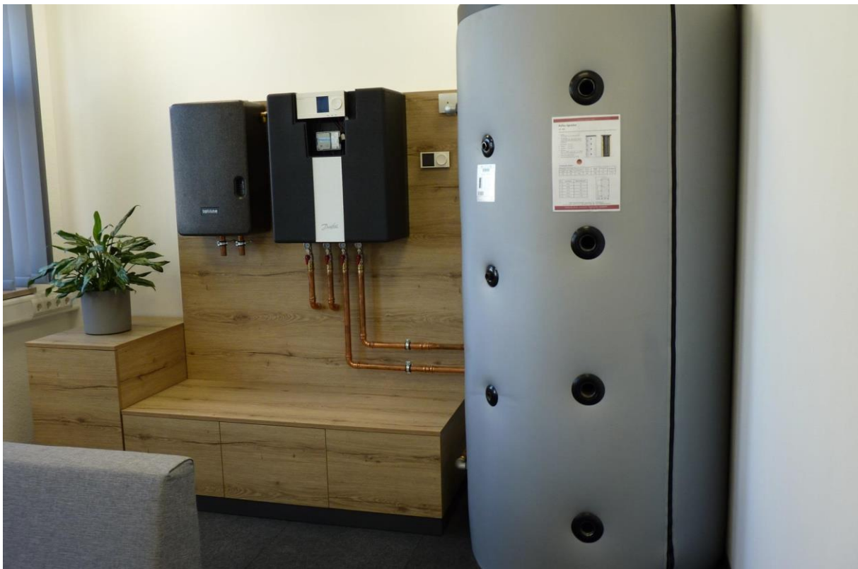
Im „Showroom“ konnten sich die Besucher anschauen, was es braucht für die Nahwärme: links die Übergabestation, rechts der Pufferspeicher. //Britta Schnake
